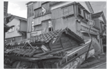
倒壊した家屋
