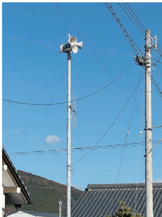
防災行政無線屋外スピーカー
