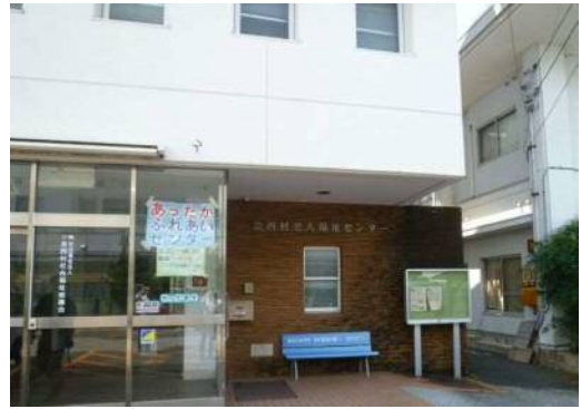
②外壁の落下、窓ガラスの割れはないか （老人福祉センター）
