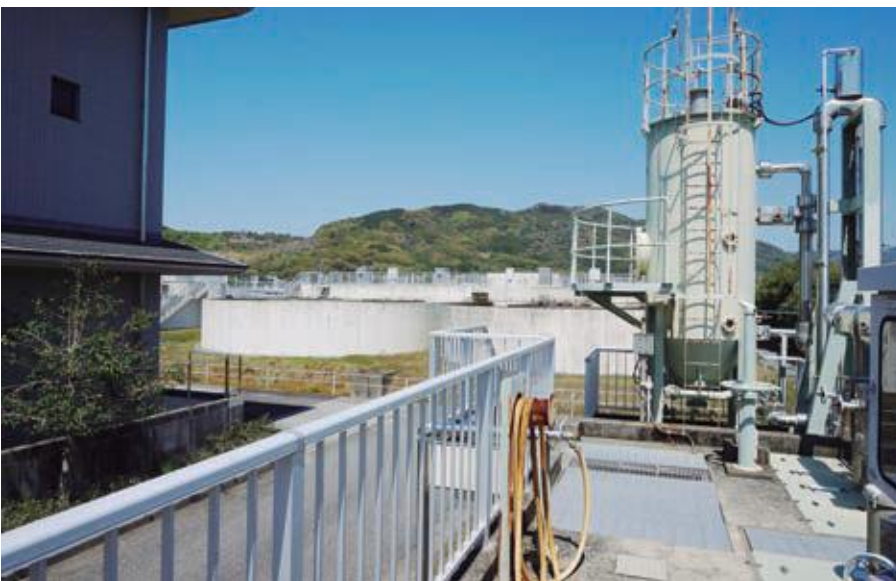
浄化センター
