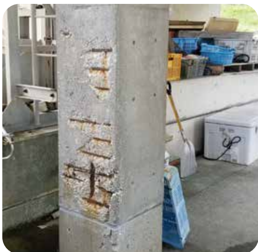
西分漁港の内の劣化した柱
